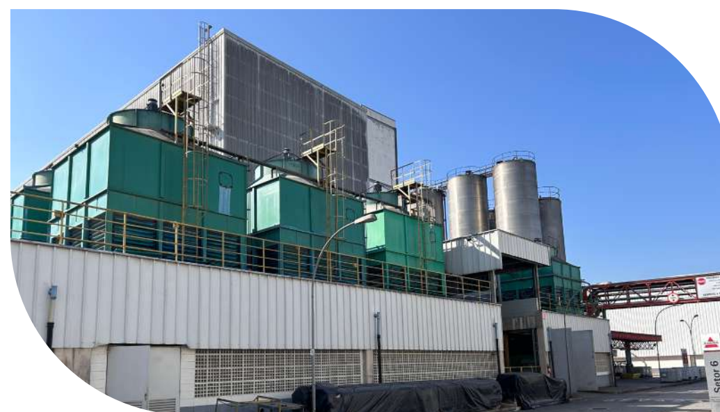
Estação de Tratamento de Água
