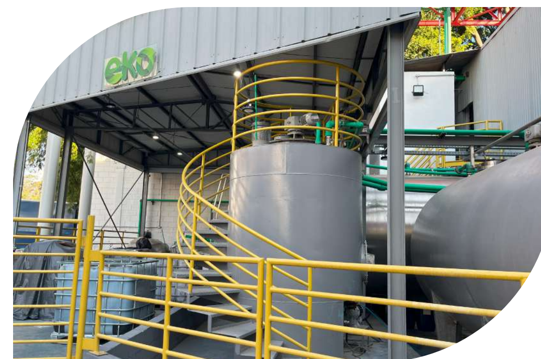
Estação de Tratamento de Efluentes
